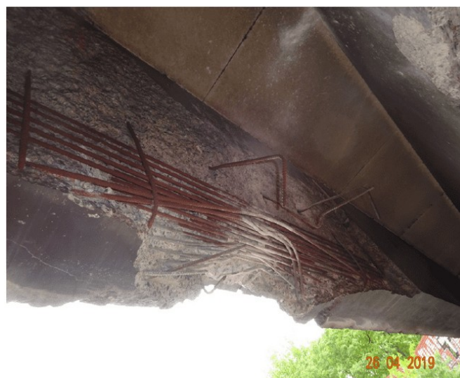
Figure 1 : Désordres suite au choc de 2019
