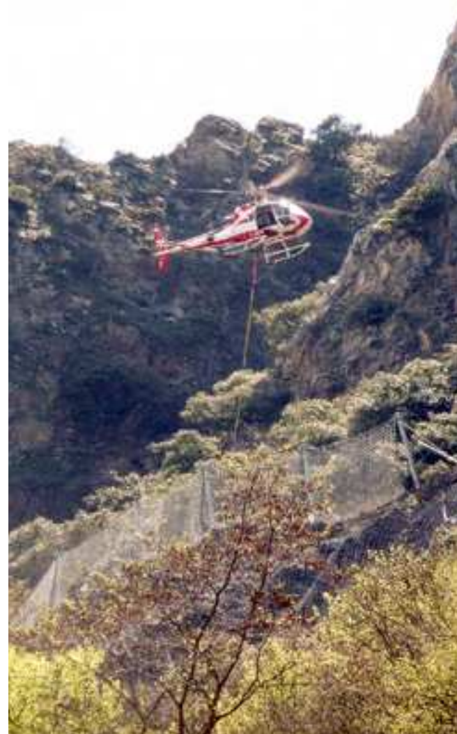
▲ Filet de protection contre la chute de blocs
